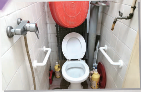
長屋設計替長者在廁所旁 安裝扶手架，讓長者活動更安全。
